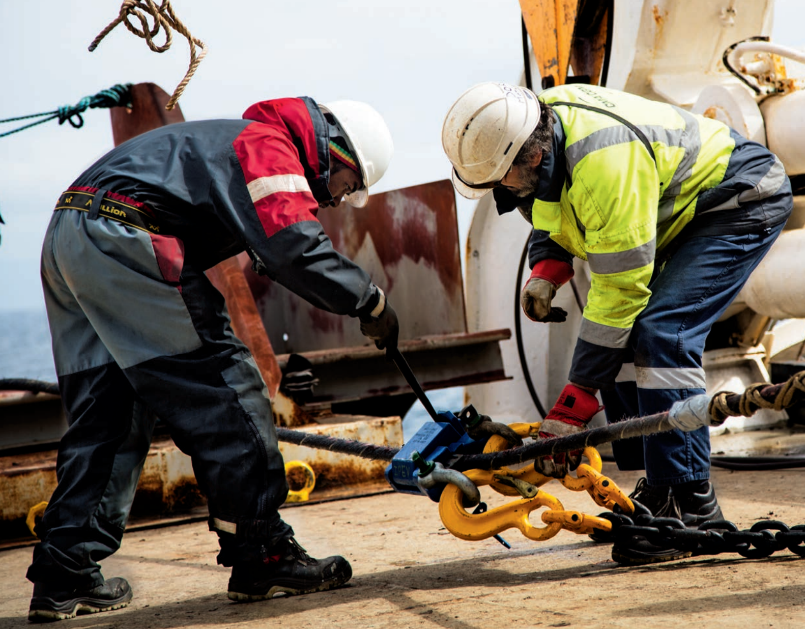
Установка гидроакустической станции НА4 (острова Крозе, Франция).
