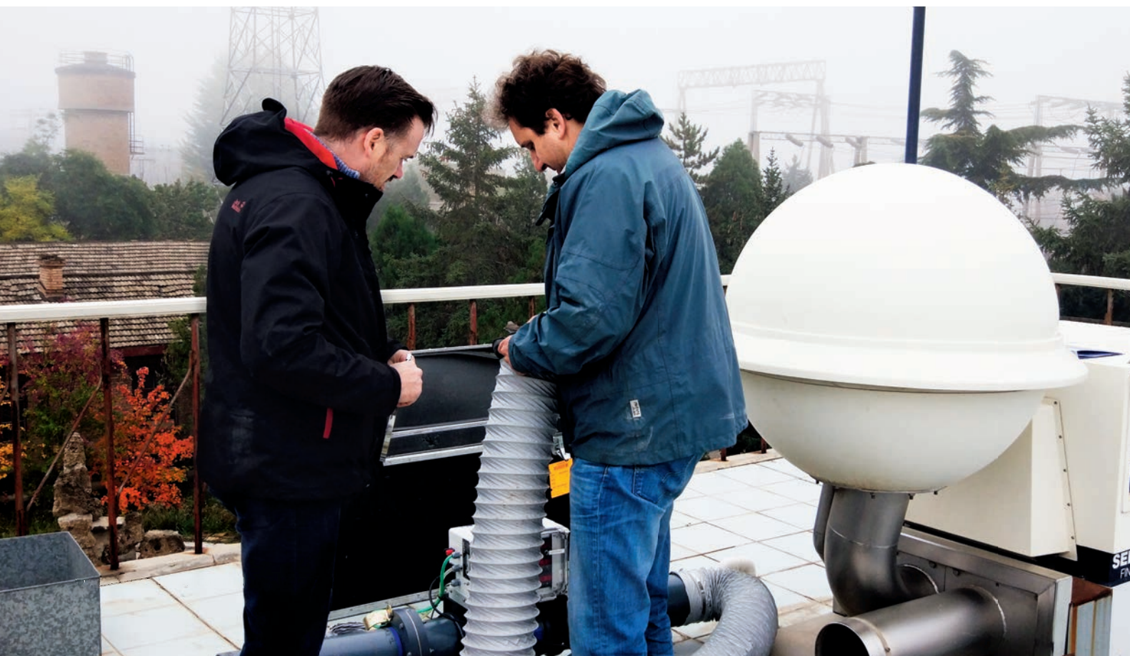
Установка радионуклидной станции RN21 (Ланьчжоу, Китай).
